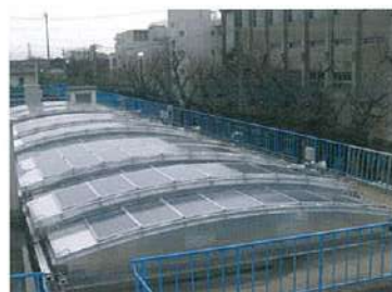
浄水用可動式覆蓋(太陽光パネル付)例
